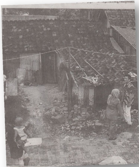
Kondisi Rumah Reyot, tanpa WC Lokasi : Kelurahan Tambakharjo, Semarang Barat Sumber : Harian Semarang Metro, Edisi 8 April 2014
